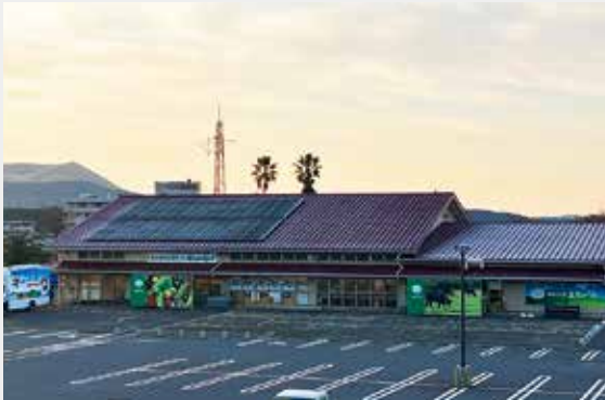
産直市場「五島がうまい」の屋根に取り付けられた太陽光パネル
